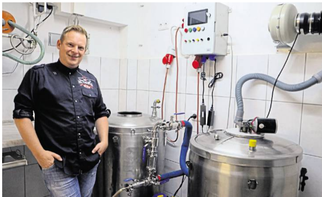
Das Herzstück der Home-Brauerei: die zu Braukesseln umfunktionierten Milchkanister im ehemaligen Waschkeller.
